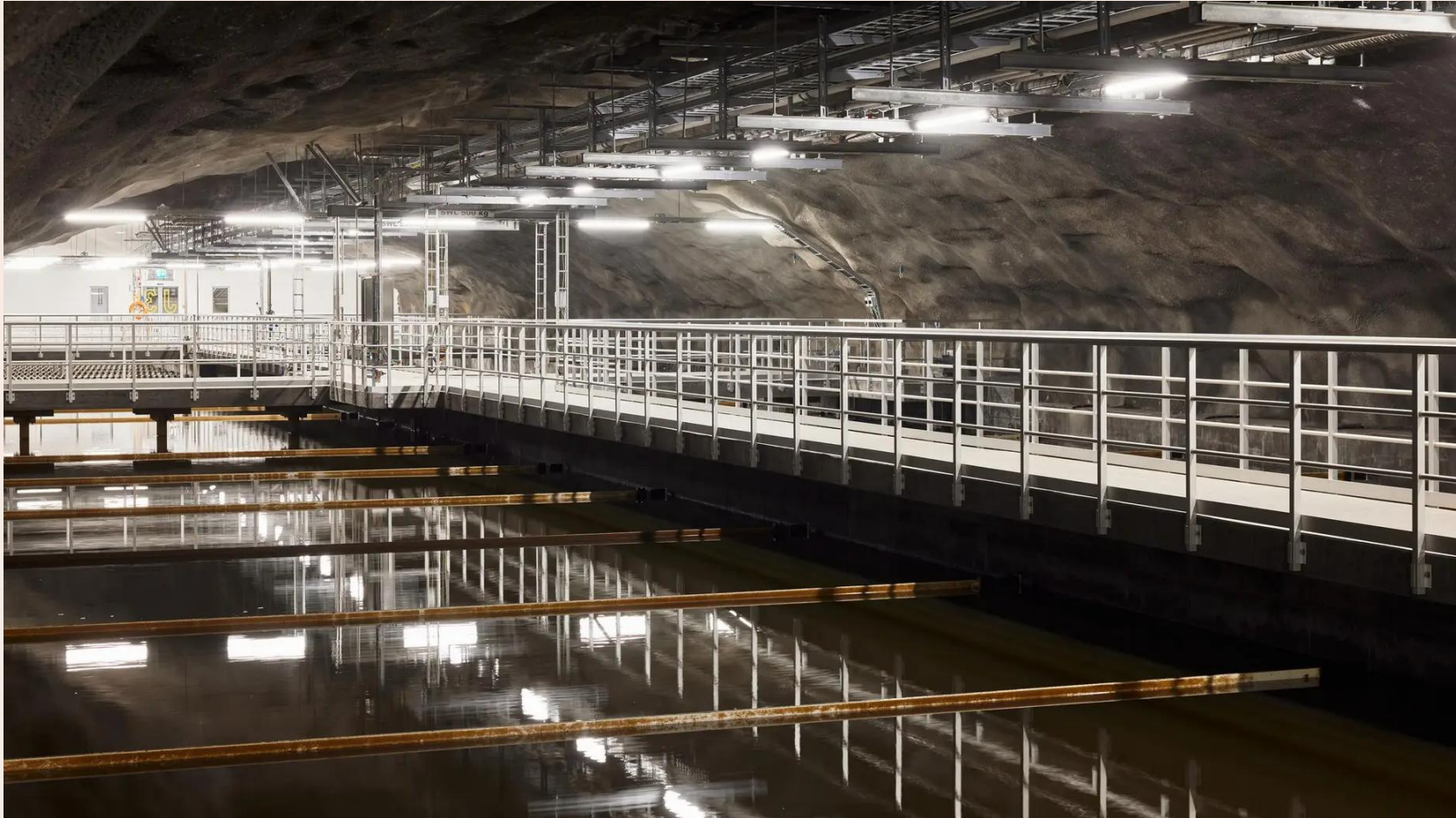
HSY, Blominmäen jätevedenpuhdistamo
